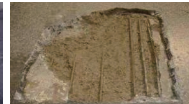
床版上面土砂化の状況
