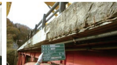
補修10年後の再劣化状況
