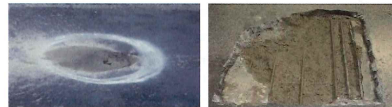
橋面舗装の異常
