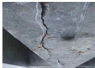
コンクリート橋桁のひび割れ
