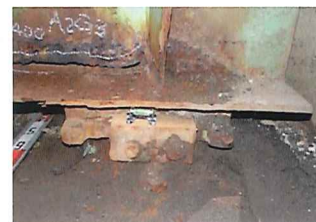
鋼橋桁端部の腐食
