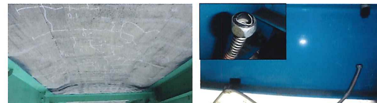
早期に発生した床版ひび割れ
