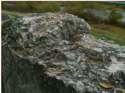
凍害によるスケーリング
