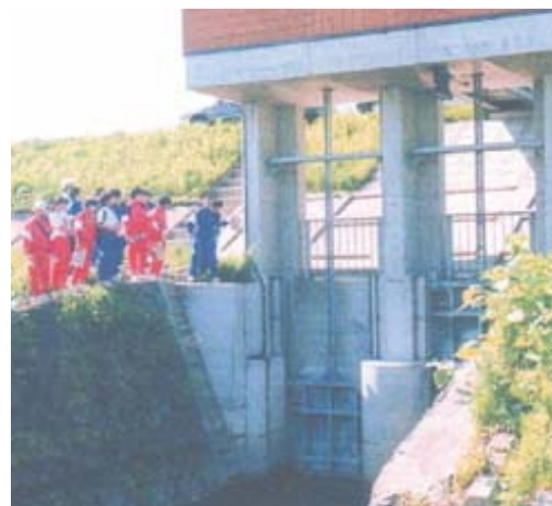
大きな水門を目の前にして水防の大切さを実感します
