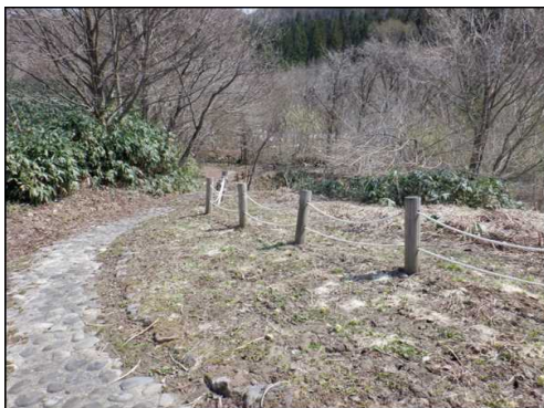
●木杭の一部劣化
