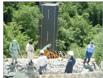
図2 岩手・宮城内陸地震(H20.6)における被害状況(祭時大橋)
