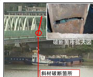
図6 本荘大橋斜材破断
