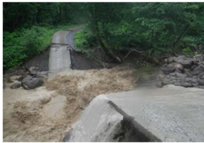
工所用道路が流出(志津)
