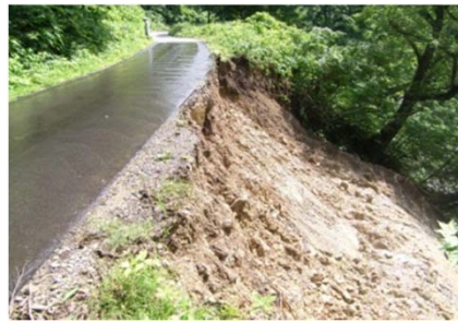
林道の損傷(見附)
