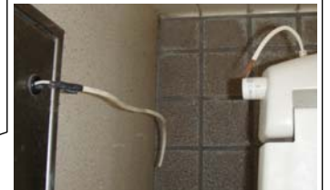
便座ヒーター 損壊
