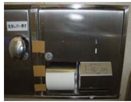
収納BOXカバー 損壊
