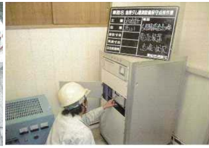
水位観測装置の点検
