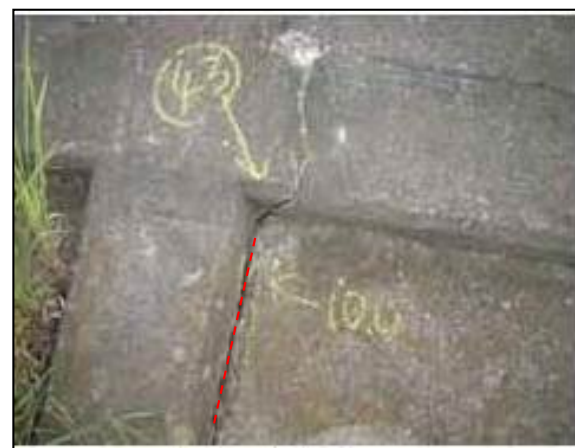
護岸損傷状況(クラック)
