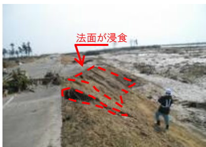
名取川左岸 0.3k 津波による堤防法面浸食
