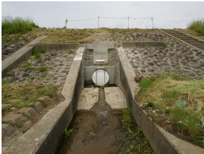
バランスウエイト式フラップゲート
