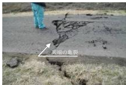
名取川左岸 2.9k 地震による堤防天端クラック
