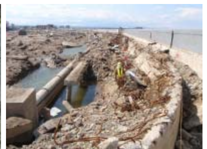
名取川右岸 0.2k 津波による堤体の流出
