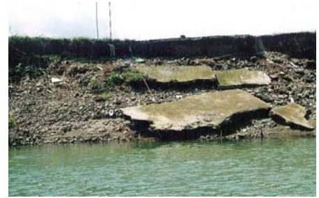
河岸崩壊の状況 名取川 5.0km 付近 (平成 11 年 8 月洪水)
