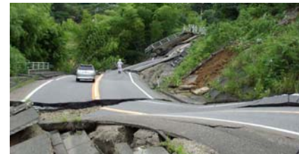
被災状況調査
