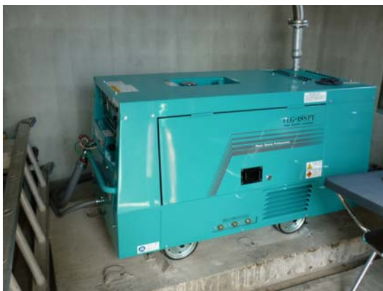
発電機設置状況(地震前)
