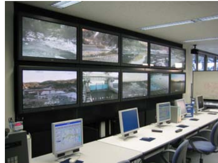
ダム放流設備制御装置
