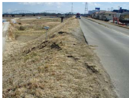
車両による堤防損傷
