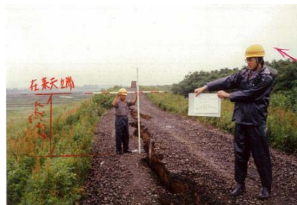
堤防の亀裂・沈下
