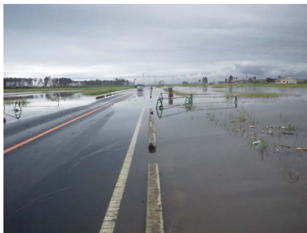
台風 15 号 (平成 23 年 9 月) による浸水状況 (仙台市若林区井土地先)
