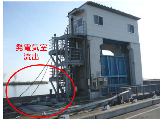
閉上水門(被災後)
