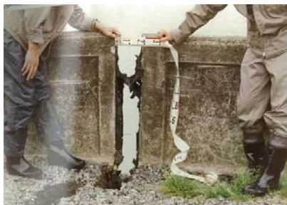
関上特殊堤接合部の開口
