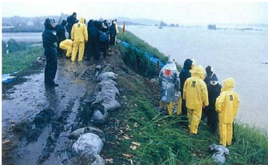
S61.8洪水 藤塚地区法崩れの状況
