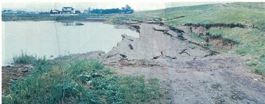
関上堤防裏法面のすべりによる亀裂
