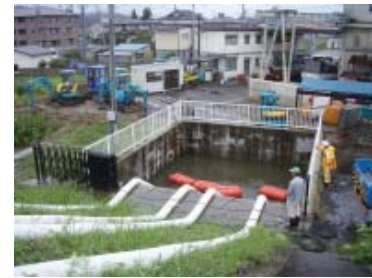
【白石川排水ピット】
