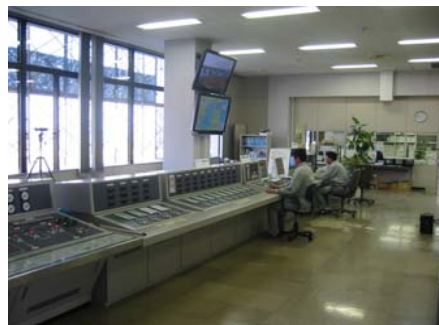
堰操作室状況
