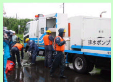
排水ポンプ車現地到着
