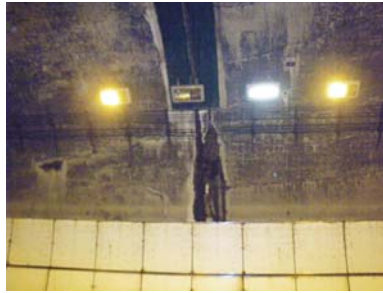
【アーチ部の漏水】
