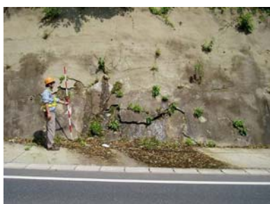
【防災点検及び モルタル法面の剥落状況】
