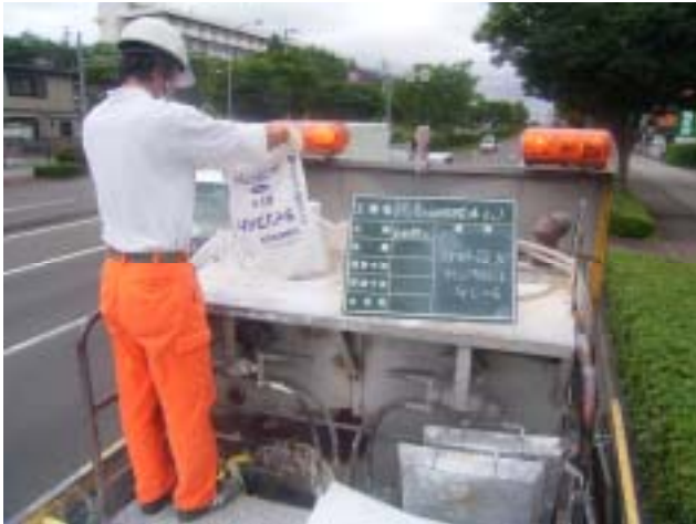
溶融釜に材料を入れてるところ
