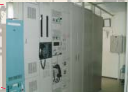
＜情報機械室＞ 無線や光ケーブルなどの様々な通信設備が集約・管理されています。
