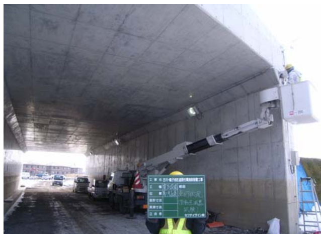
試験点灯状況
