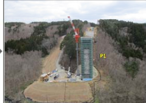
H30.4.4撮影 橋脚足場の組立・クレーンの組立後、 橋脚の施工を行いました。
