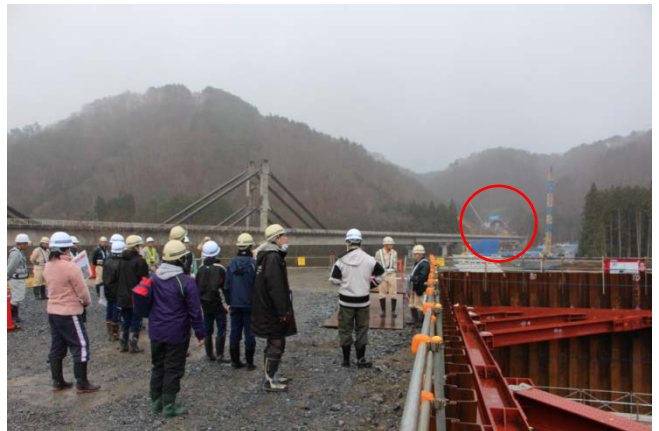
▲(仮称)新小本大橋の下部工工事現場 奥に見えるのは小本トンネル北側坑口 北側からは約20m掘削が進んでいます
