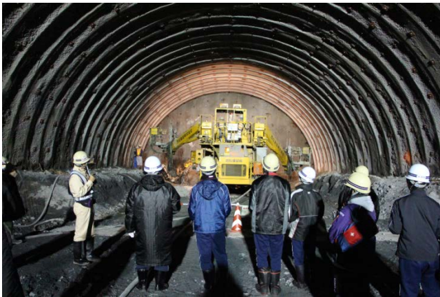
▲(仮称)小本トンネル(1,134m) 南側掘削最深部 約390m地点で工事説明
