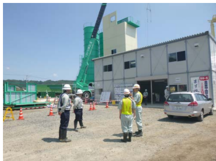
▲工事を加速するため建設中の公共生コンプラントを見学
