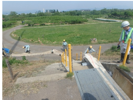
▲ホース設置状況
