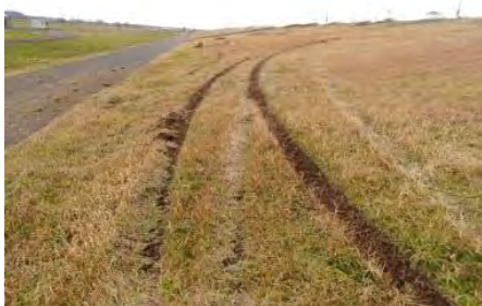
▲自動車走行により損傷した堤防のり面
