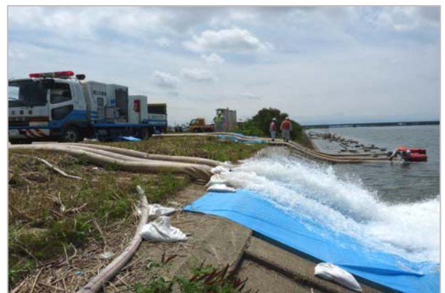
▲ 排水ポンプ車稼働の様子
