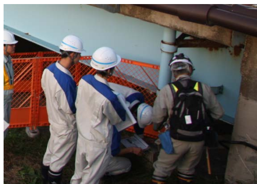
▲鋼桁及び支承の腐食状況確認
