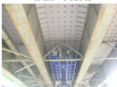
▲主桁の腐食状況確認
