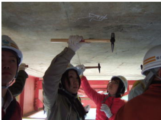
コンクリート床版をハンマーで叩いて音の違いを確認しました。
