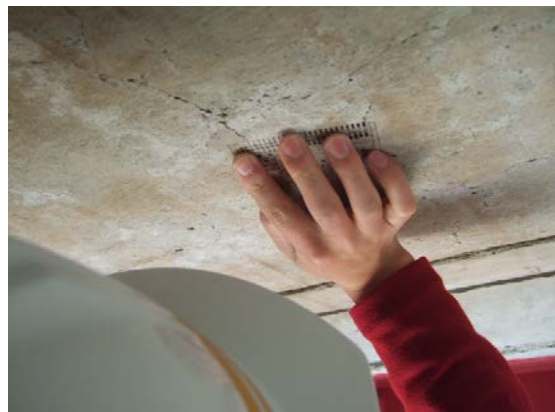
クラック（ひびわれ）の幅をスケールで計測してみました。
