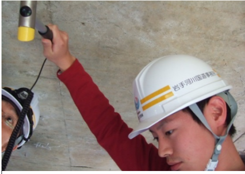
床版コンクリートの強度を計測ハンマーで確認しました
