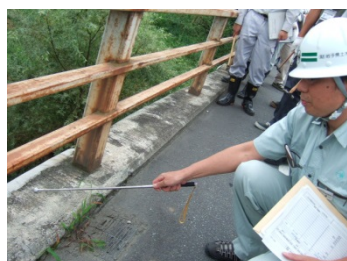
▲地覆コンクリート剥離状況の確認
