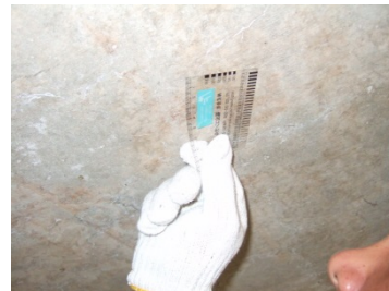
▲クラックスケールによるひび割れ状況の確認
