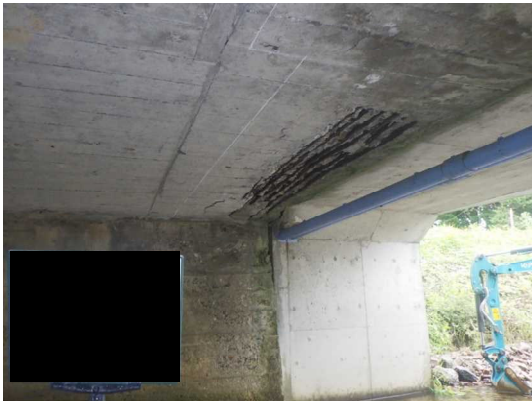
写真4-2 【損傷】鉄筋露出
