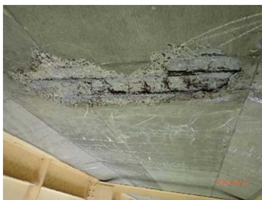
写真4-8 【損傷】 床版下面に浮き、剥離・鉄筋露出
