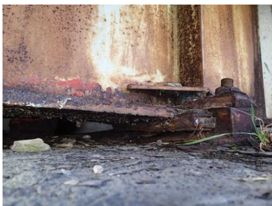
写真4-11 【損傷】支承の腐食
