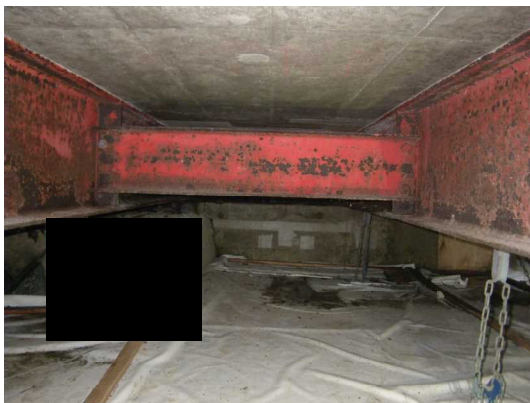
写真4-14 【損傷】主桁の腐食
