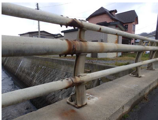
写真4-5 【損傷】防護柵の腐食欠損
