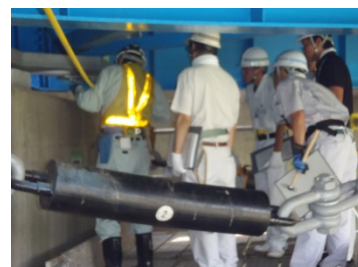
▲桁端・杓廻りの損傷状況確認
