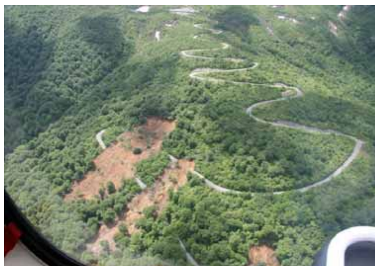
6 / 17 撮影 法面崩落
