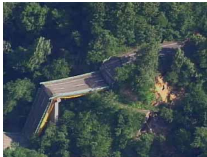
6 / 15 撮影 巖美町祭時大橋落橋
