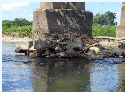
▲ 橋脚に流木の漂着を確認
