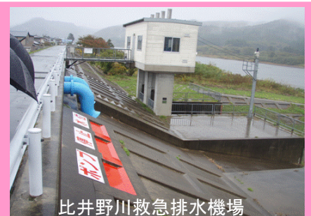
【ポンプ運転停止水位の表示状況】
