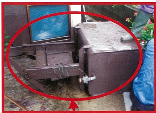
老朽化によるホームタンクの倒壊
