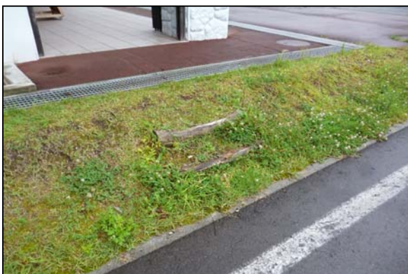
▲木製階段が腐食しており、転倒の危険性がありました。 (北秋田市:森吉山ダム広報館)
