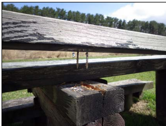
▲テーブルのネジが外れ、板が浮いていました。(秋田市:水辺の広場)
