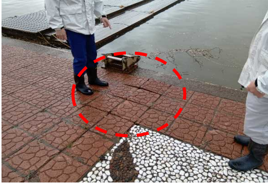
●護岸ブロックタイトルの段差
