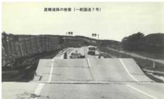
一般国道7号 堤防被災状況
