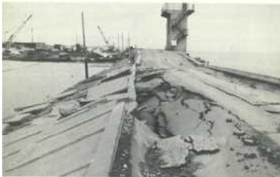
能代市中島地区 堤防被災状況
