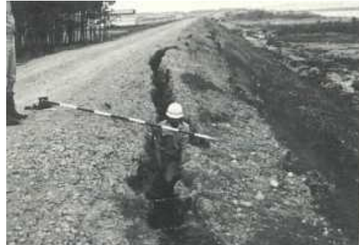
能代市落合地区堤防被災状況
