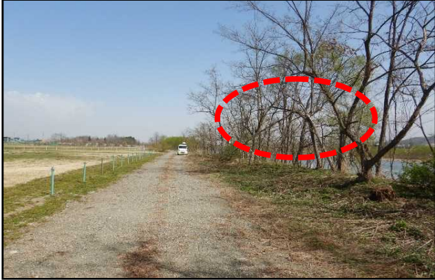
●通路への木の枝の張り出し
