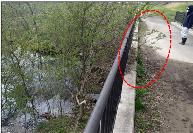
●通路への木の枝の張り出し
