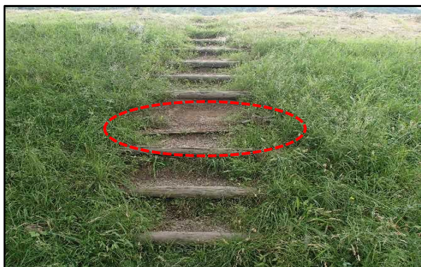
●木製階段の破損
