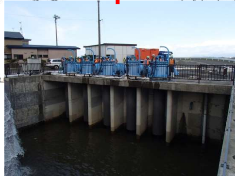
排水機場(吸水側)
