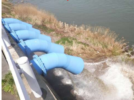
排水機場排水状況(吐口側)
