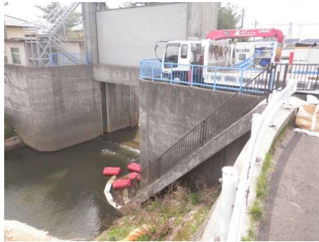
排水ポンプ車設置状況
