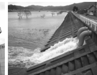
排水ポンプ場排水状況
