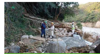
令和元年東日本台風による国道349号の被災状況
