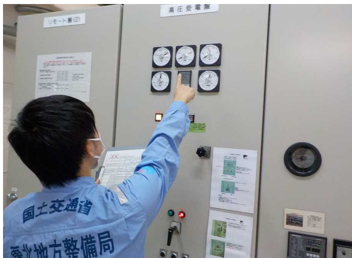
管理施設の点検状況(受電設備)
