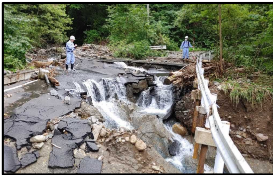
▲町道の被災状況
