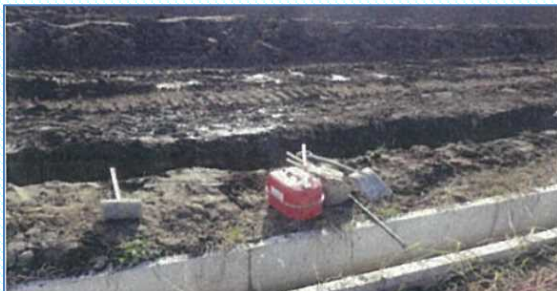
油脂携行缶が水路のそばにあり、水質事故の恐れあり。
