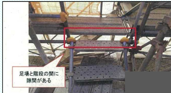
足場と階段の間に隙間がある。 囲いの中の足場階段の継ぎ目部に隙間がある。
