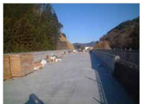
現在は橋の上で壁高欄(車の逸脱を防ぐコンクリートの壁)を施工しています。
