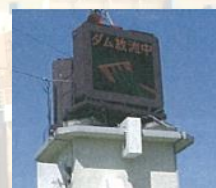
大型電光表示板
