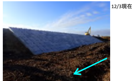
現在の工事の状況写真（決壊箇所）
