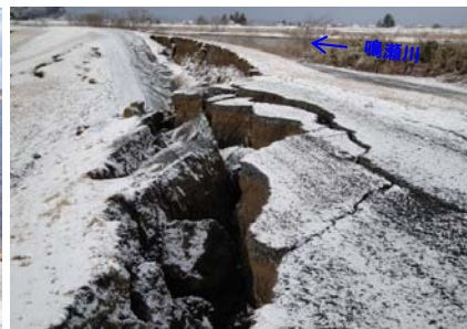
地震により天端沈下と縦断クラック発生 (鳴瀬川左岸11.4k付近 美里町二郷砂山地先)
