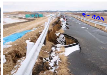
地震により縦断クラック発生 (吉田川左岸14.4k付近 大崎市鹿島台大迫地先)
