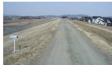
東北地方太平洋沖地震後の状況 (鳴瀬川左岸12.9k付近)
