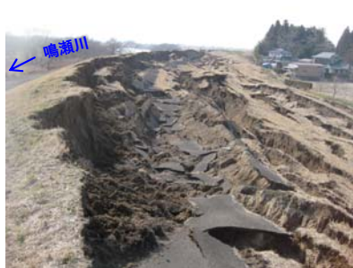
地震により堤体が崩落 (鳴瀬川左岸30.3k付近 大崎市古川下中目地先)
